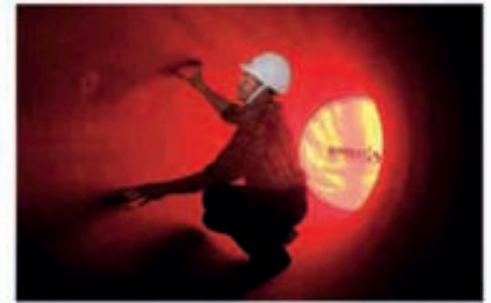
Рабочий, осматривающий газопровод для транспортировки природного газа, Россия
